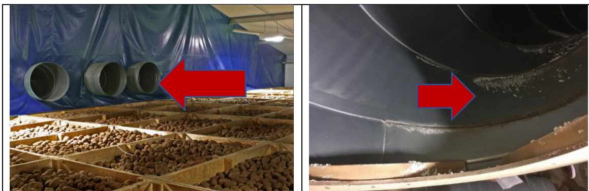
Figuur 4 en 5: Luchtkoeling en luchtgeleidingsbuizen in kistenbewaring.
